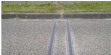
Lichtslangen in het wegdek. Foto Flow NV België
