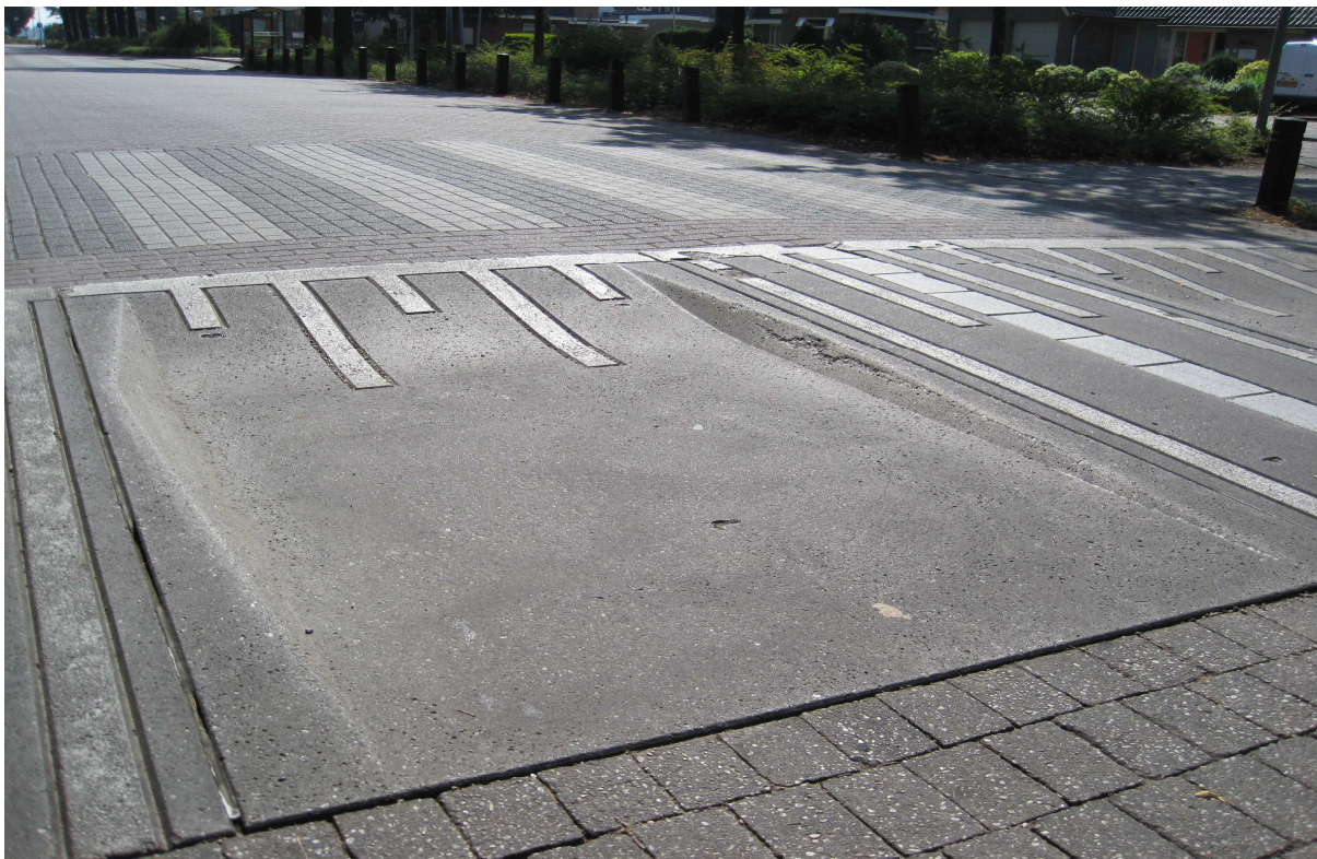
Betonnen verdiepingen met afgeschuinde zijkanten als snelheidremmer. Zelfs in het midden tussen de twee rijbanen in. Geen of nauwelijks een probleem voor automobilisten. o.a. voor motorrijders absoluut onaanvaardbaar wegens de gevaarzetting, bij elke snelheid.
